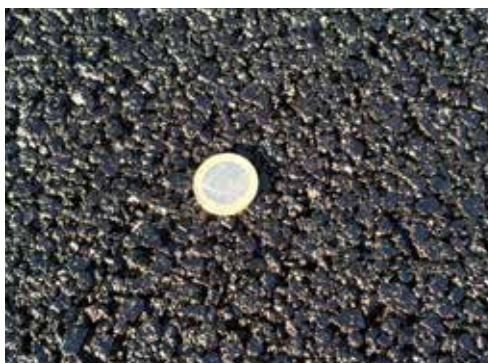
3. Esempio di manto di usura fonoassorbente: la mitigazione del rumore è ottenuta per assorbimento dell'energia acustica
