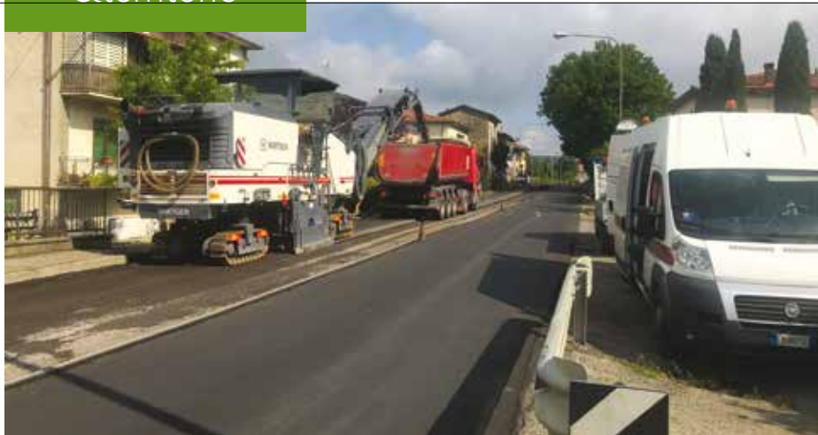
4. La realizzazione dei siti sperimentali: rimozione della pavimentazione esistente e posa in opera del nuovo strato di usura
