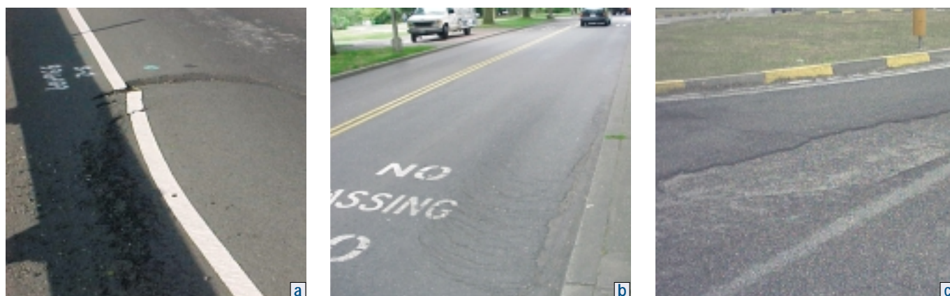
FIG. 1 Slittamento di conglomerato di usura senza asportazione e con distacco superficiale
